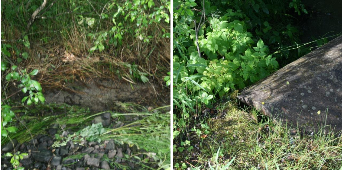
Kuva 13. Radan alta tulevan rummun viimeinen betonikiekkko on irti, virtaus on syövyttänyt vastapenkan ja uomaan on kertynyt kiviä.
