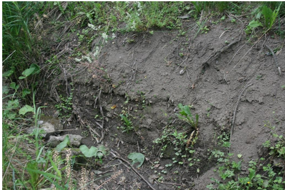
Kuva 29. Uomaerosio on paikoin voimakasta.
