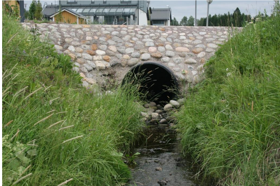
Kuva 33. Eriksnäsiñoja alittaa Ristikadun isossa muovirummussa, jonka jälkeen uoma on leveä ja syvä.
