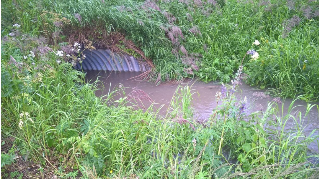
Kuva 59. Pajalantien varren huoltoaseman ajotien rummussa oli runsaasti vettä inventointihetkellä (kuva otettu runsassateisena päivänä).
