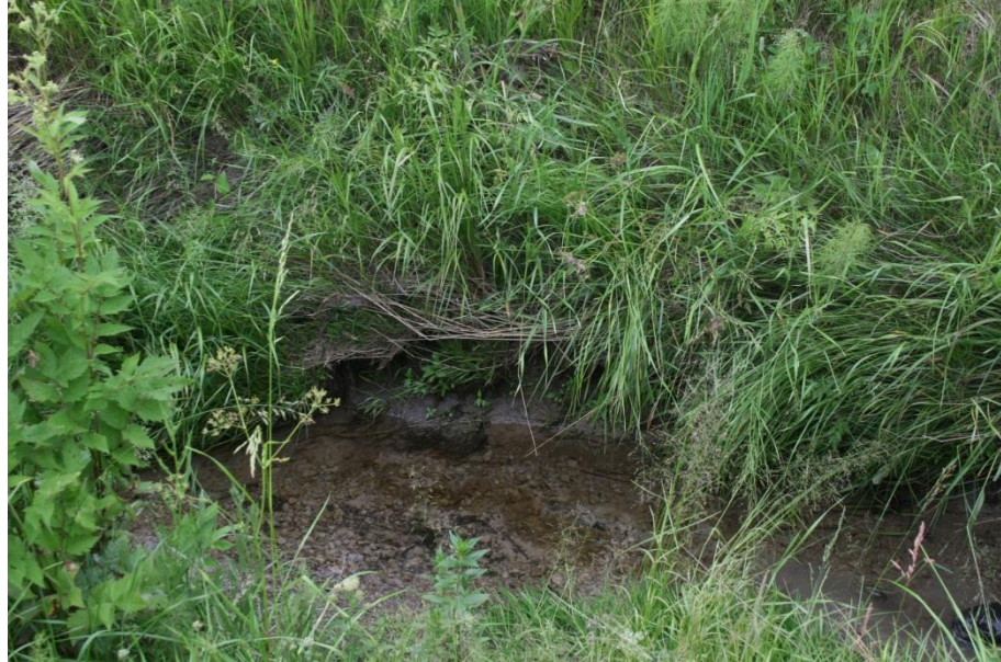
Kuva 35. Uoman pohja on lajittunutta ja uoman alaosissa on paikoin syöpymiä.
