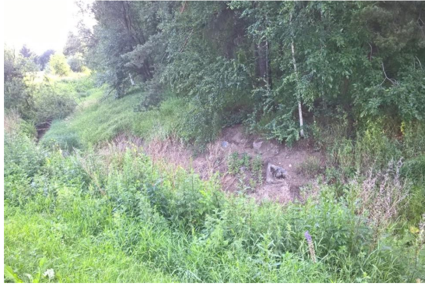
Kuva 53. Sivu-uoman yläosalla on voimakasta eroosiota.
