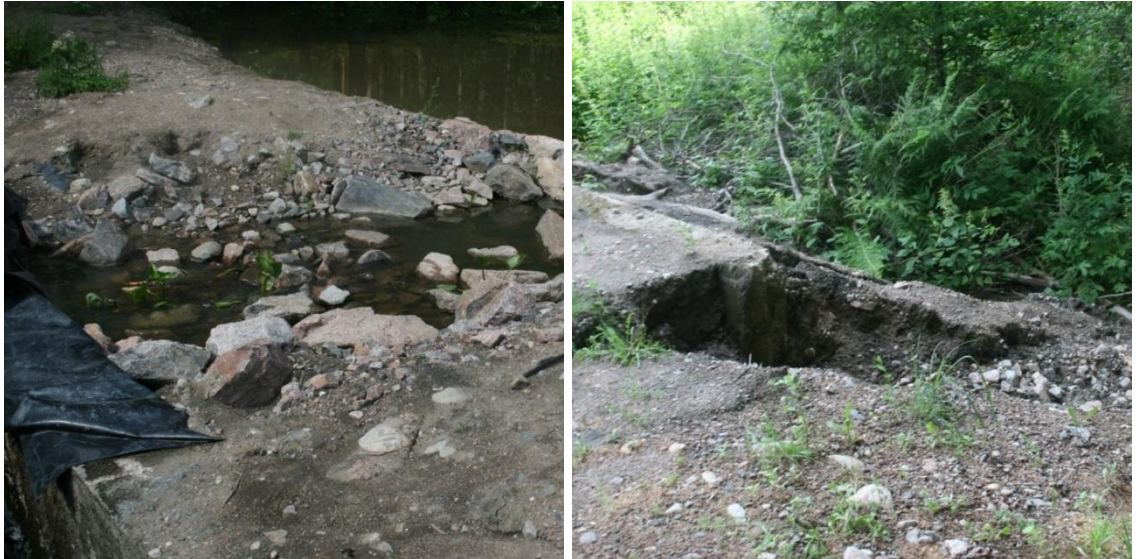
Kuva 107. Patorakenteesta on lähtenyt maa-ainesta sekä keskeltä että patorakenteen reunoilta virran mukaan.
