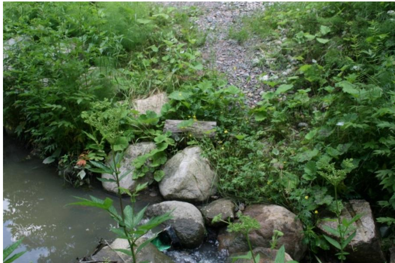
Kuva 116. Noro on kivetty kynnykseksi yhden kiinteistön kohdalta.
