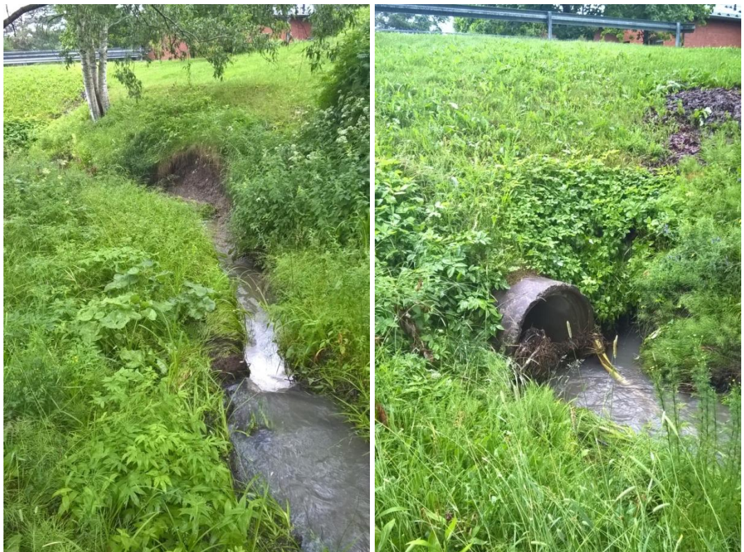
Kuva 41. a) Jyrkkä uomaosuus on osin syöpynyt b) Rumpuun on kertynyt roskaa.
