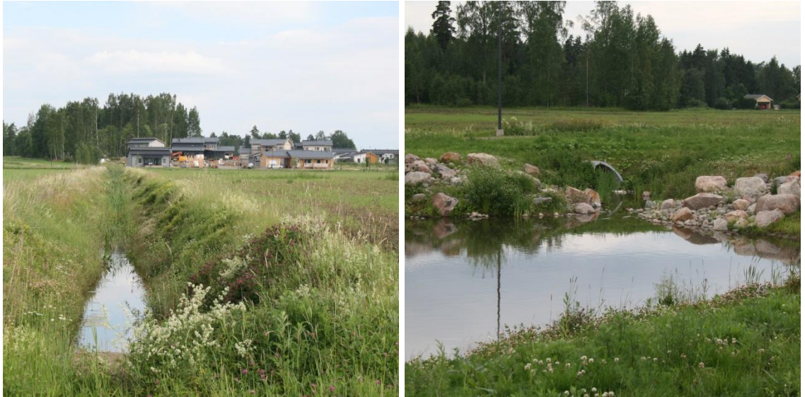
Kuva 77. Lepolan kosteikoista vedet puretaan Räkikänojaan noin 250 m Velitien jälkeen. Purku-uoma on kapea ja penkoiltaan voimakkaasti erodoitunut tuoden kiintoainesta Räkikänojaan.
