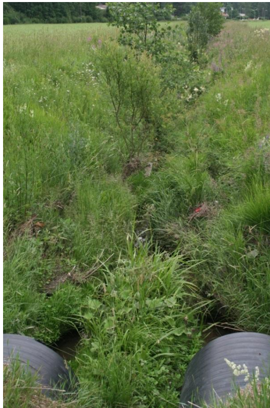
Kuva 34. Uomassa on paikoin penkkasortumia.
