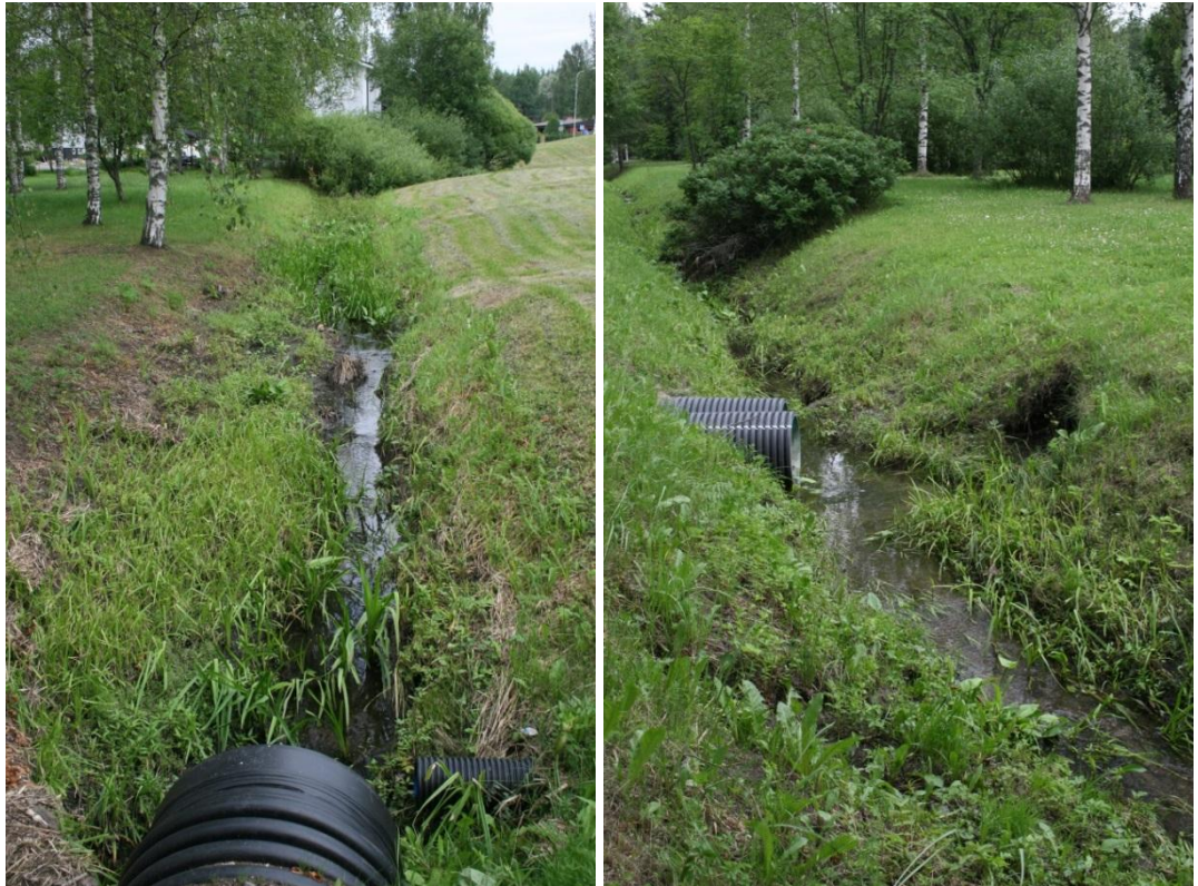
Kuva 71. a) Kulmakadun pohjoispuolisella puistoalueella ei uomalla ole monimuotoisuutta eikä luontoarvoja. b) Hulevesipurputket ovat syövyttäneet ojan penkkaa huomattavasti.
